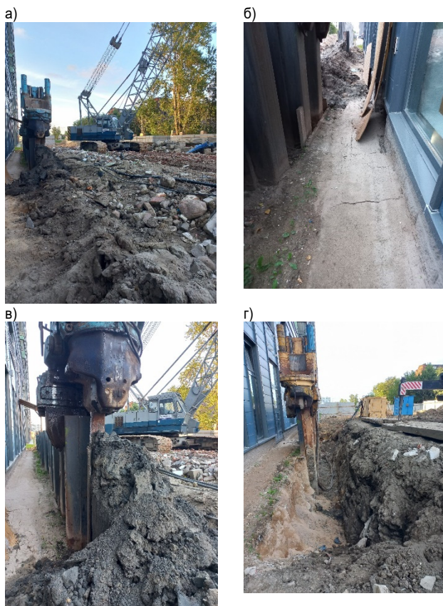
Рис. 5. Этапы статического извлечения шпунта (фото автора): а – УВШ, установленная на извлекаемом шпунте; б – трещины в бетонной отмостке, образовавшиеся в процессе работ; в – грунт, извлекаемый на поверхность вместе со шпунтом; г – траншея, выполненная в примыкании к шпунтовой стенке для снижения сопротивления грунта
