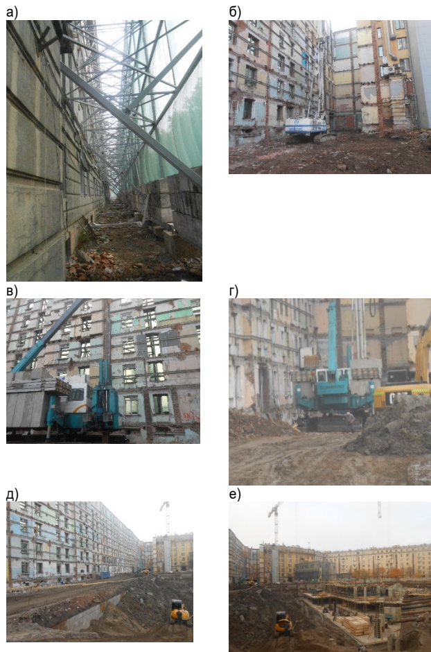
Рисунок 1. Фото участка вдавливания свай (выполнено автором статьи): а – стена фасада, закрепленная на стальных рамах; б – буровая установка для устройстве скважин при погружении в них свай; в, г – установка вдавливания, оснащенная краном; д – стены в грунте с отсыпкой по её периметру грунтовой бермой; е – участок устройства подземных конструкций здания в котловане
